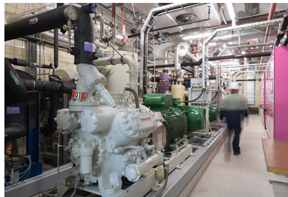
Wärmeverbund Rheinfelden Mitte: Die AEW bereitet sich auch beim Betrieb der 78 Wärme- und Kälteverbunde auf die drohende Strommangellage vor.
